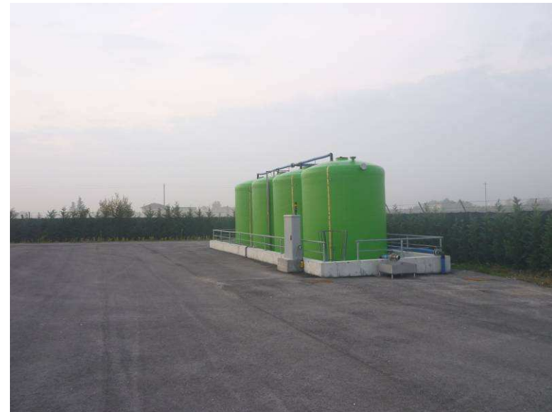
Cisterne di stoccaggio del percolato
