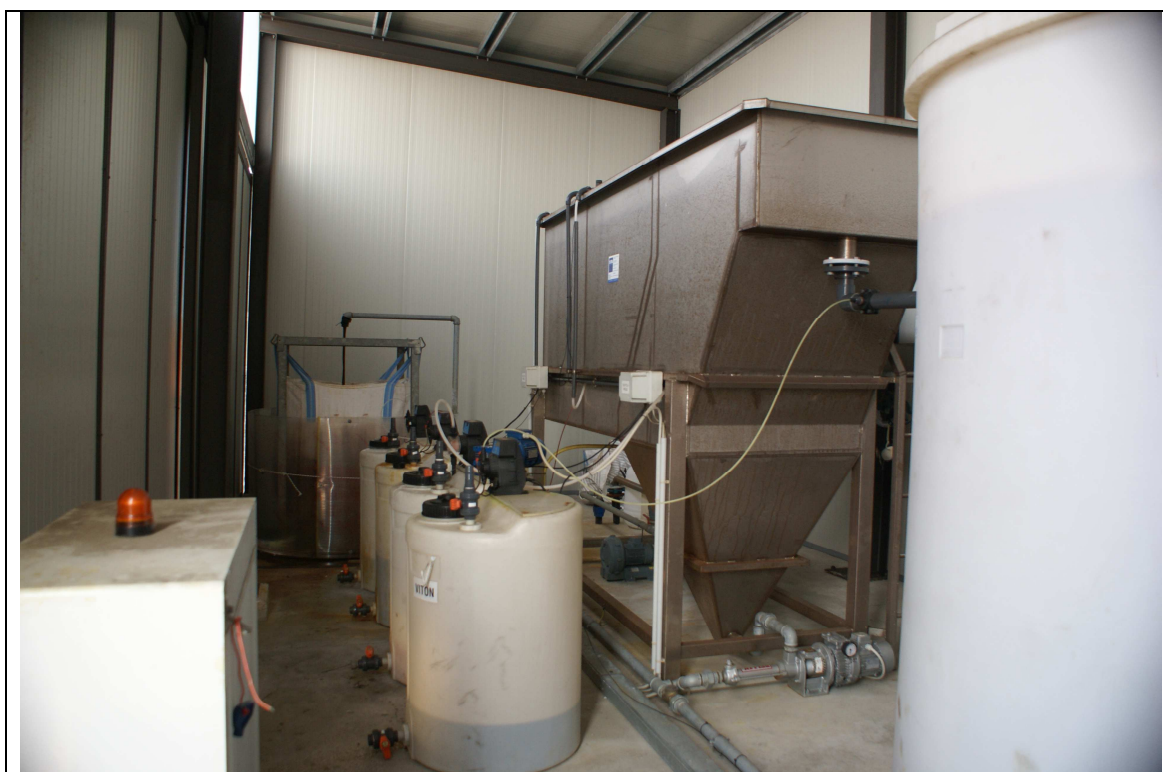
FOTO 3.4: Impianto di trattamento delle acque intercettate dalla rete di raccolta nei piazzali esterni.
